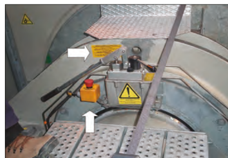
Imagen 106. Acceso a la nacelle
