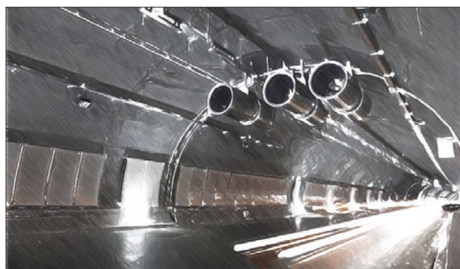
Imagen 13. Ventiladores en túnel
